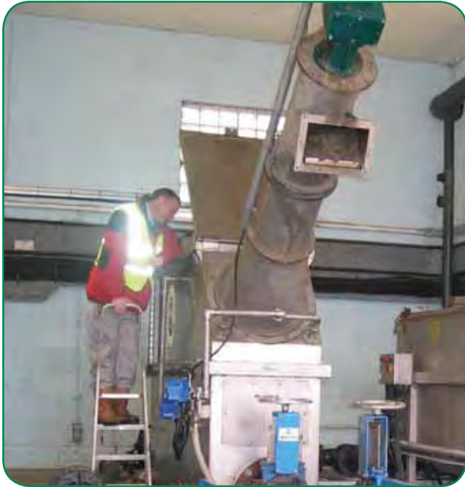
“Honey Monster” монтиран в завод за третиране на утайки в Обединеното Кралство.
